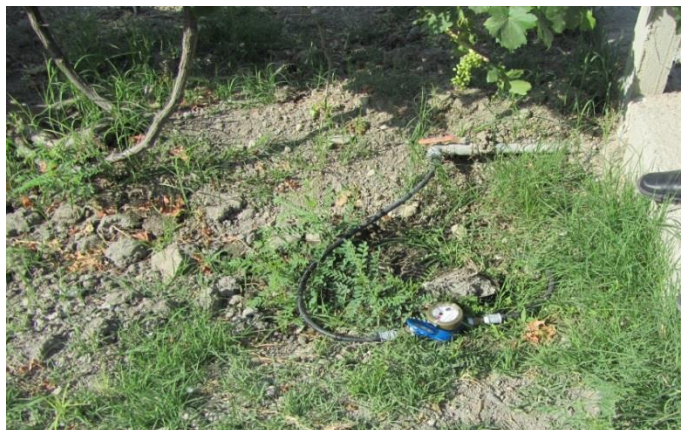
شکل ۹- نصب کنتور آب برای کنترل کارکرد قطره‌چکان‌ها و آگاهی از انسداد آن‌ها (نورجو، ۱۳۹۴)
