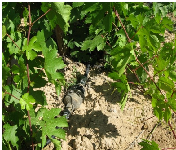
شکل ۲- نصب کنتور جهت اندازه‌گیری آب مصرفی
